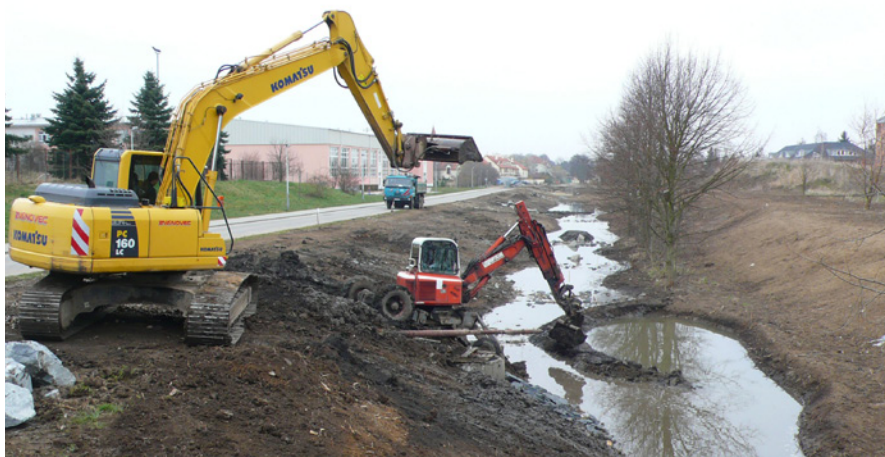
Podzim 2014 – první fáze prací v prvním úseku revitalizace. U hostivické školy již bylo rozsáhlým odtěžením zemin rozšířeno hlavní koryto potoka, následuje rozvolňování kynety. Foto Tomáš Just
