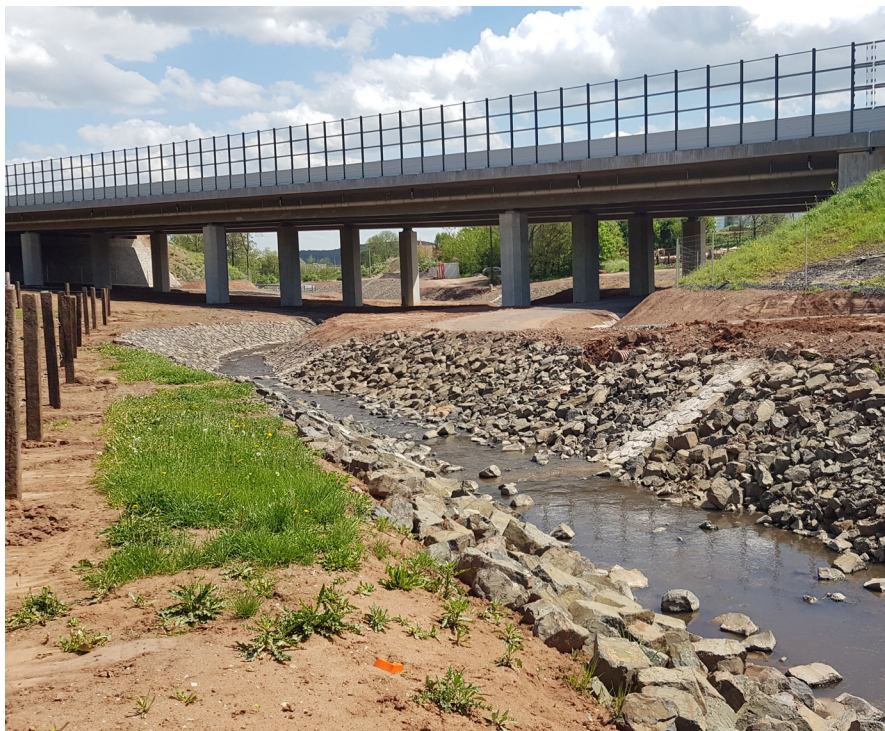
Dálnice D6 Lubenec, obchvat. Přeložka Blšanky je provedena mimo most kamenným záhozem, v podmostí rovnalinou s kynetou ve dně. Na mostě jsou umístěny ocelové sítě, které nutí netopýry přelétávat most ve větších výškách a minimalizují tak počet srážek vozidel s netopýry. Foto Vlastimil Bogdan
